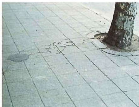
Platantræets rødder sprænger fliserne
