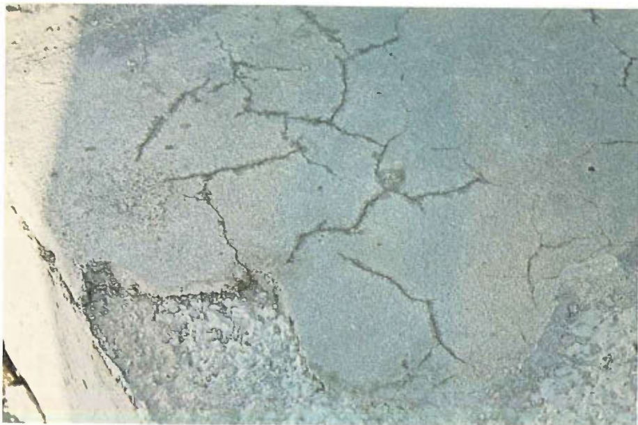
Revnet pudslag på opkørsel
