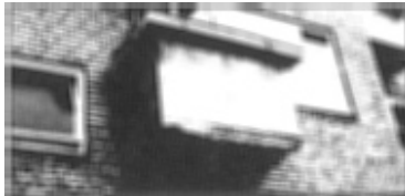
I mange ejendomme kan der konstateres svære korrosions- og frostskaeder. De bærende profiler undermineres af rust og altanen bliver en dødsfælde.
