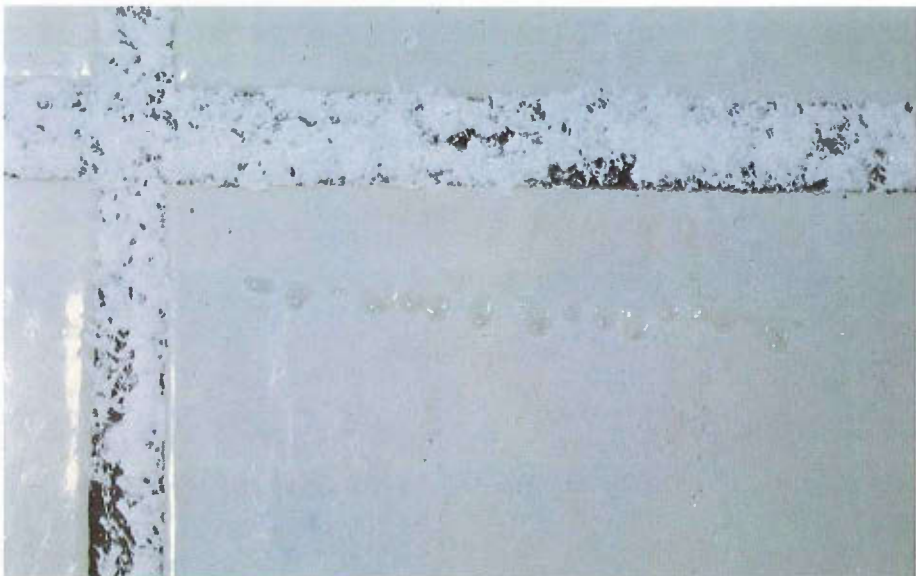
Geludsivning fra revne i flise
