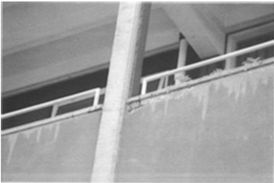
Armeringsjern i altanbrystninger næsten rustet væk
